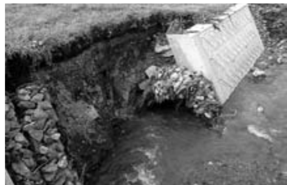
災害復旧箇所が8月9日の集中豪雨により再度の被害を受ける(大迫町地内)
