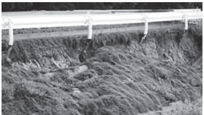
8月9日、各所で発生した土木被害
