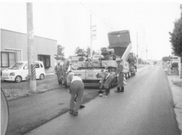
施設等の修繕を計画的に行っています(道路の修繕工事)
