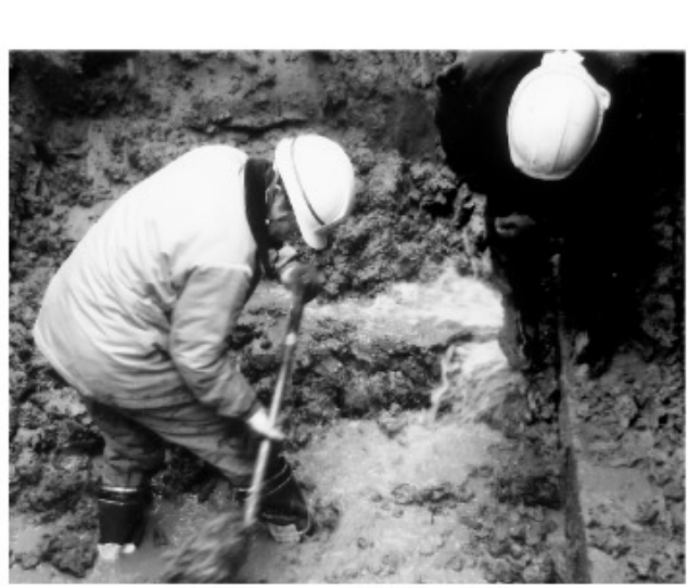
漏水している水道管の修理
