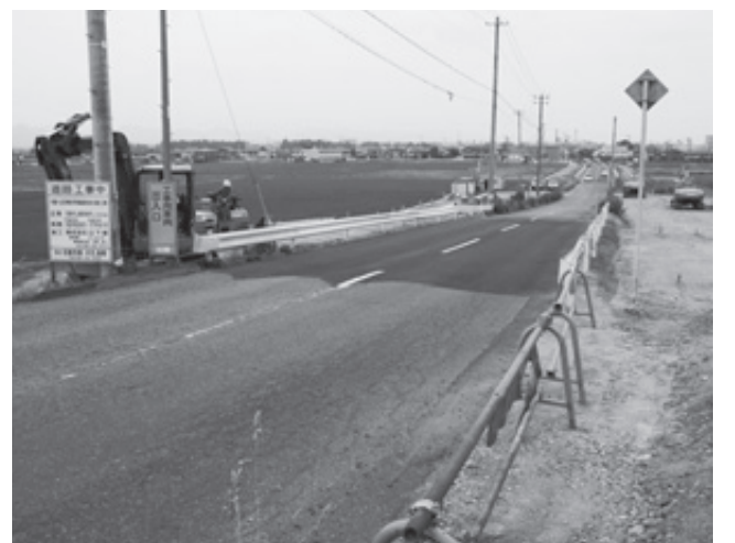
予定どおり工事が進んでいる「市道山の神桜木町線道路(函渠)改良工事」
