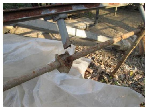
地際部の腐食による折れ
