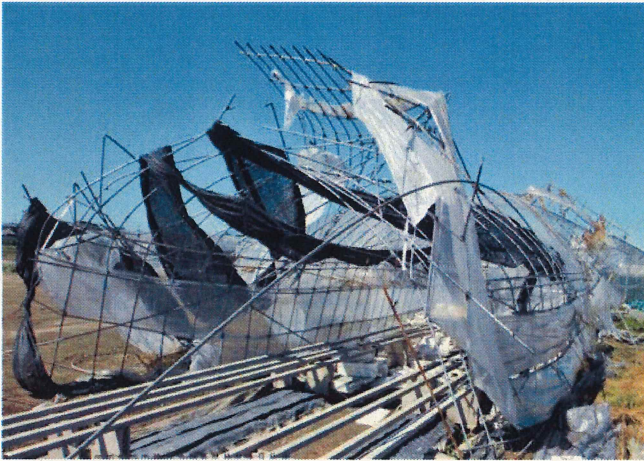
台風被害の様子
