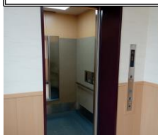
エレベーター
