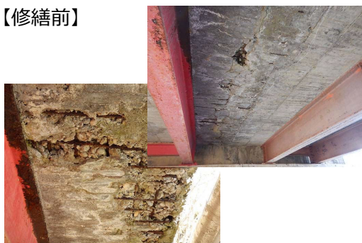
【損傷状況】剥離・鉄筋露出/腐食
