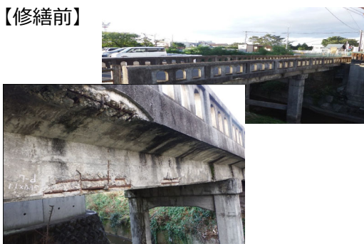
【損傷状況】剥離・鉄筋露出
