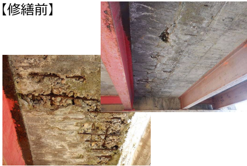
【損傷状況】剥離・鉄筋露出/腐食
