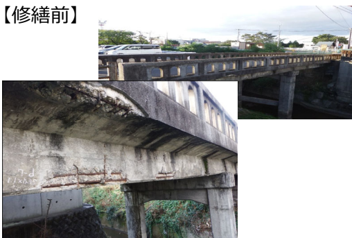
【損傷状況】剥離・鉄筋露出
