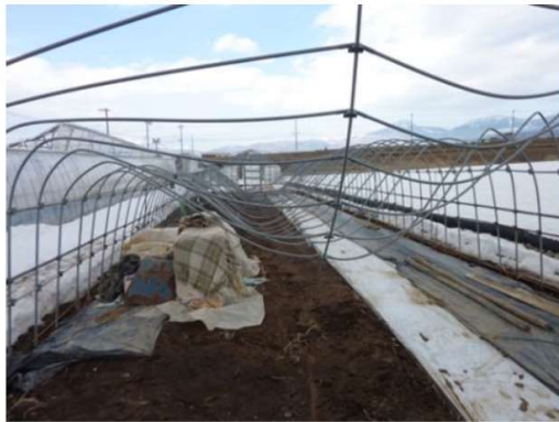
単棟パイプハウスのM字型陥没
