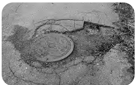
除雪による舗装剥離
