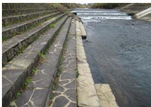
陥没したステップ（右岸）
