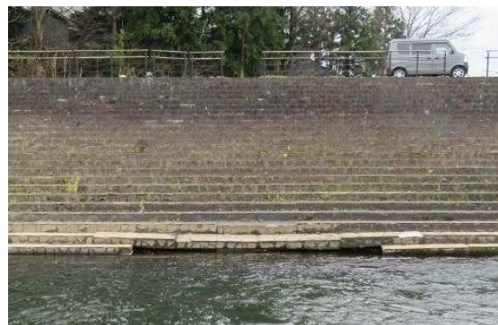
崩落している水辺プラザの階段護岸
