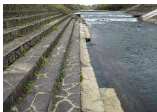
陥没したステップ（右岸）
