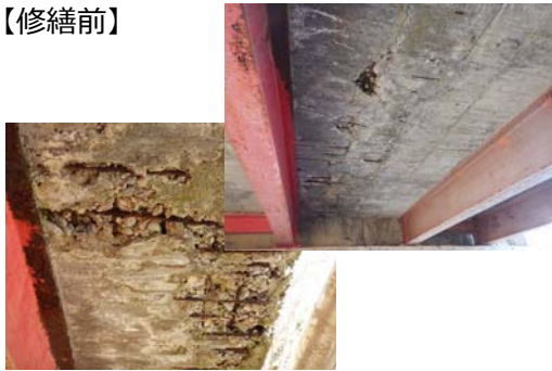
【損傷状況】剥離・鉄筋露出/腐食
