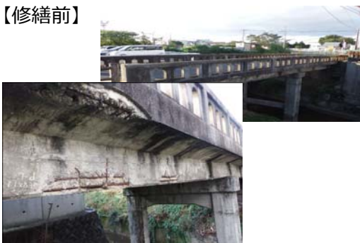
【損傷状況】剥離・鉄筋露出
