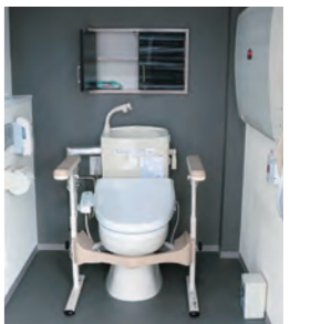
▲温水洗浄便座なども備えた個室トイレです
